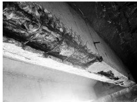
图1 钢筋锈蚀斑驳破损严重
