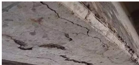
图2 钢筋腐蚀裂缝
