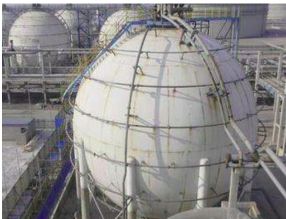
图2 安全喷淋设施
