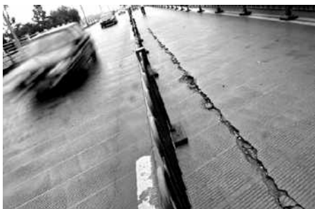
图1 道路工程裂缝现象
