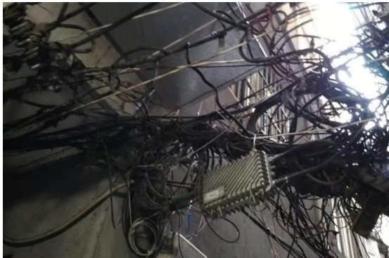
图3 电力基础设施老化
