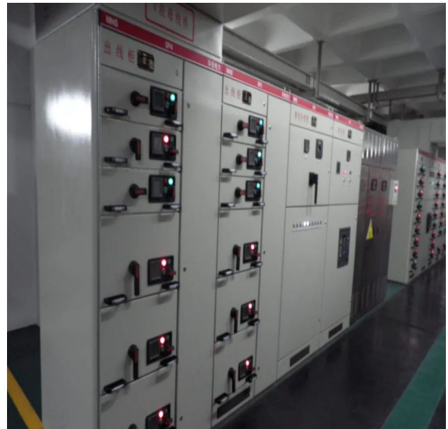
图1 住宅小区供配电设施
