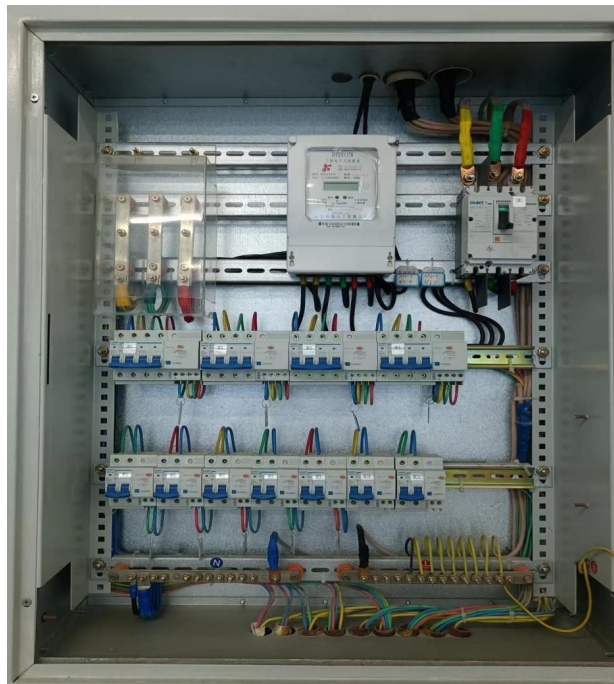
图二：实验室配电柜
