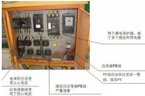
图1 配电箱通病介绍
