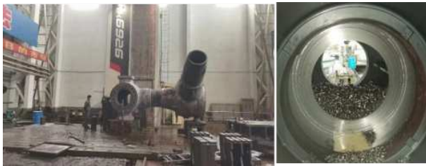
图 2 3 号机再热蒸汽调节阀扩散器裂纹检修处理过程
