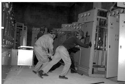
图1 高压配电柜维护图
