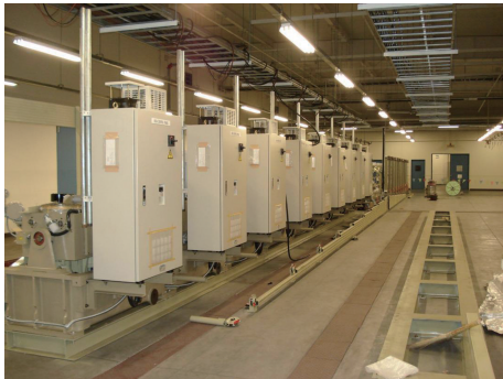
图 1 供应机电设备电工电气调试安装工程中主要的电气设备
