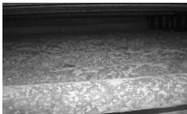
图1 高温腐蚀在管壁表面形成的锈皮示意图
