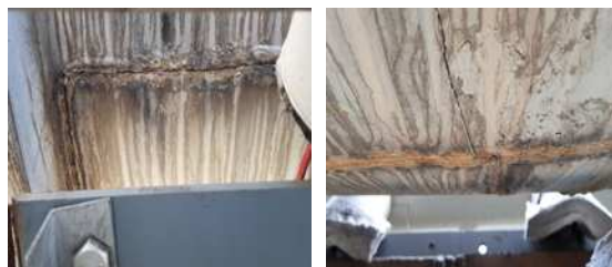
图1 空冷蒸汽分配管开裂图片
