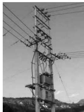
图 1 10 千伏配电线路
