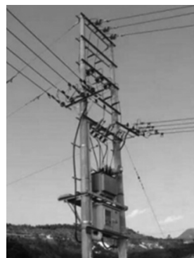
图 1 10 千伏配电线路
