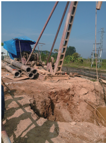
图2 未进行施工勘察导致塌孔
