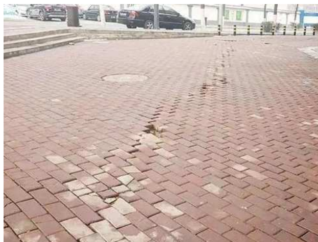
地下水过度开采导致的地裂缝
