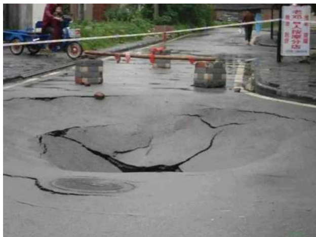
地下水过度开采导致的地面坍塌
