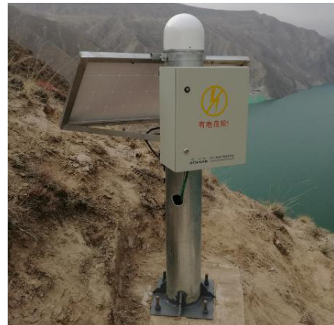
图2：自动化检测系统设备
