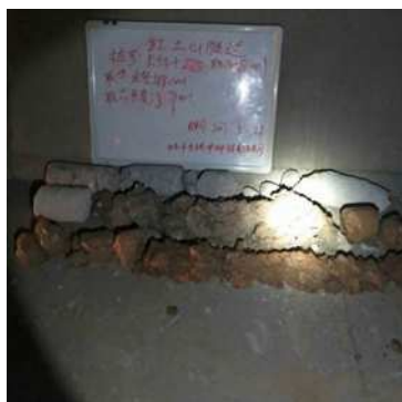
照片2-1 K54+225路面右侧
