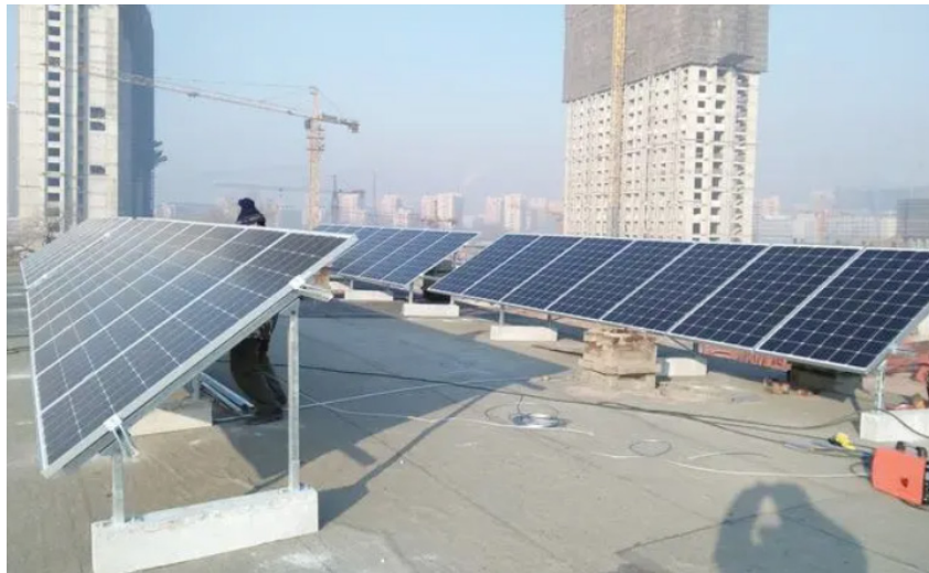
图1 太阳能光伏板
