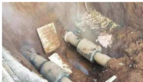
图1 某地供热管道爆裂现场图
