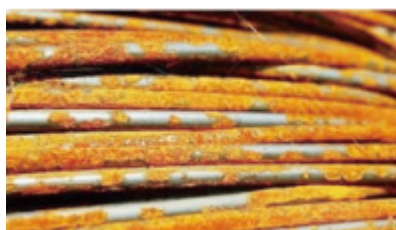
图1 钢筋锈蚀照片
