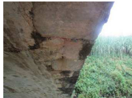
图3 拱肋砂浆脱落图
