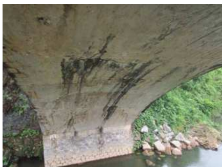
图2 拱肋渗水泛碱图
