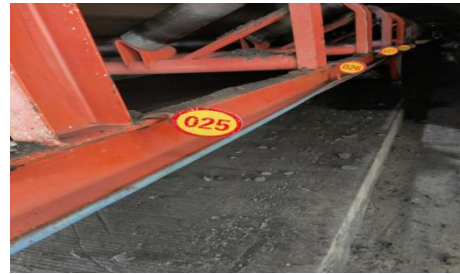
图 3 测温光缆安装位置
