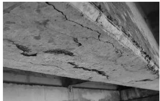
图2 钢筋腐蚀裂缝
