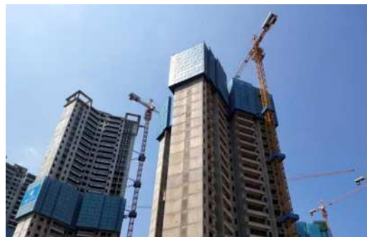
图1 建筑机电安装
