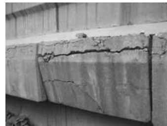
图1 房屋混凝土裂缝
