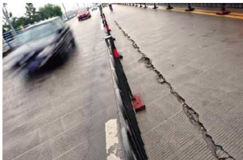
图1 道路工程裂缝现象
