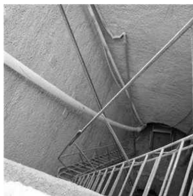
图1 高层电气竖井内的电缆敷设
