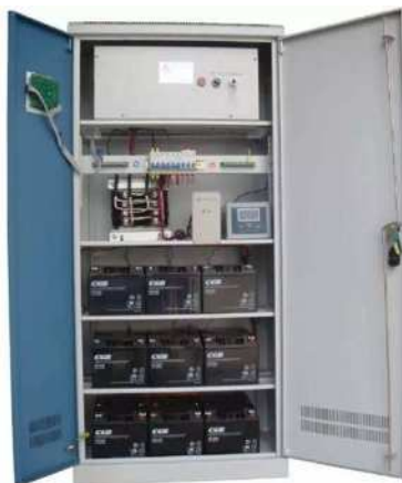
图2 高层建筑中的供配电设施
