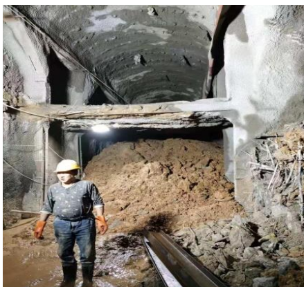
图 4 地铁车站小导洞内涌入大量水土
