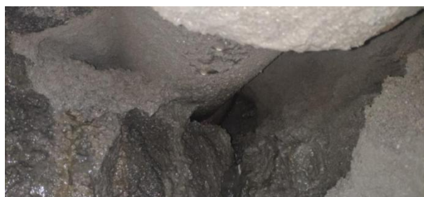
图 6 雨污水管长期渗漏
