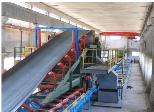
图1 发电厂输煤设备
