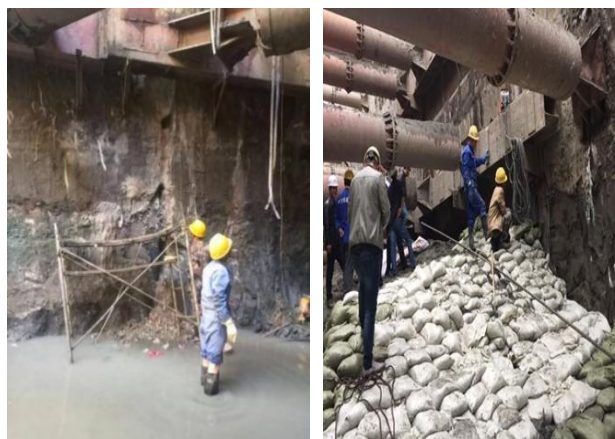
图3-1 地连墙接缝渗漏
