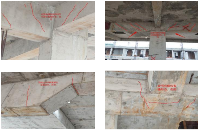
图 1-6 现场梁、板裂缝实照
