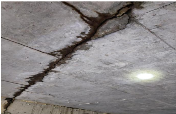
图1 桥梁横裂缝现象
