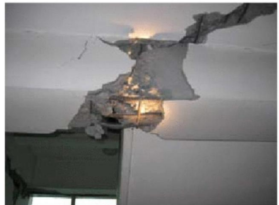
图3 框架结构梯梁剪断
