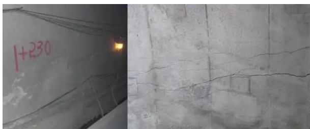
图1 冻害导致衬砌冻胀开裂
