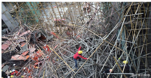
图3 脚手架倒塌事故
