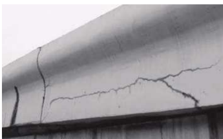
图1 温度变化引起的裂纹问题
