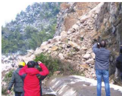
图2 某山区公路施工中边坡失稳崩塌现场
