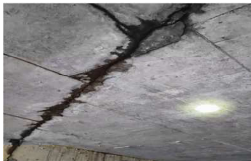
图1 桥梁横裂缝现象
