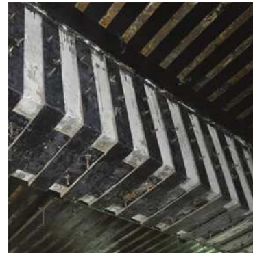
图2 钢板粘连加固技术
