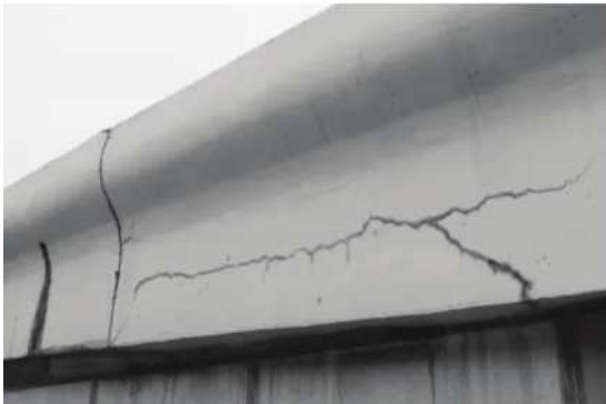
图1 桥梁裂缝现象
