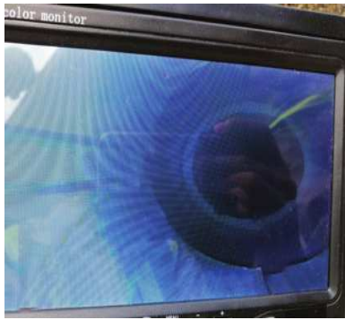
图5 测斜管断裂 (CX2, 深度 14m)
