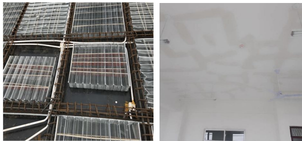
图3 密肋楼盖箱体在现场施工及施工后产生的问题
