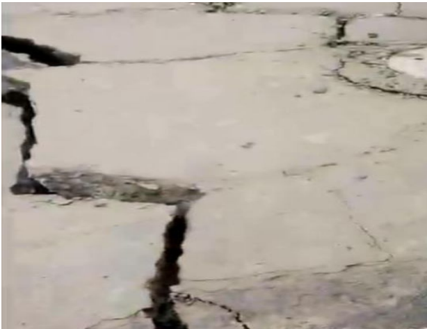
图2 施工路面开裂
