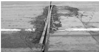
图 2 伸缩缝局部结构变形
