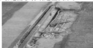
图 3 伸缩缝两侧混凝土损坏
