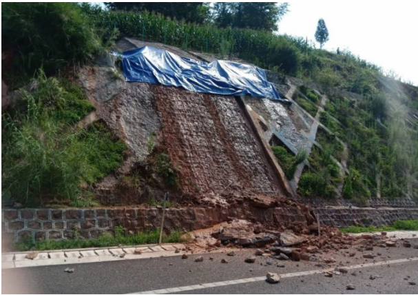
图1 路基边坡崩塌
