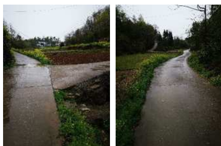
图 3 农村公路视线不良
