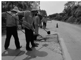
图1 路面凹槽病害现象施工处理
