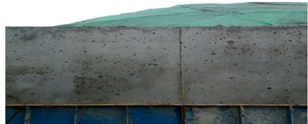
图1 混凝土外观质量通病
