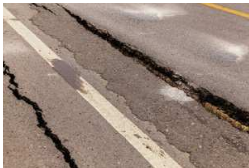
图1 沥青路面开裂现象图示
